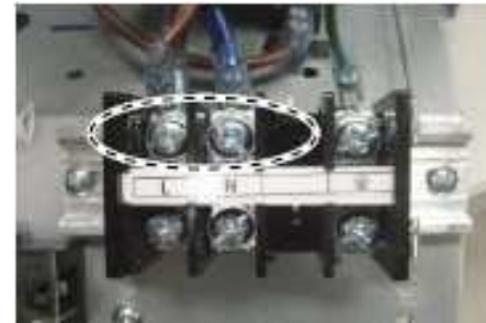
Contrôle alimentation électrique
