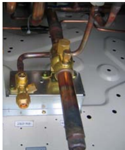
Vannes de service
