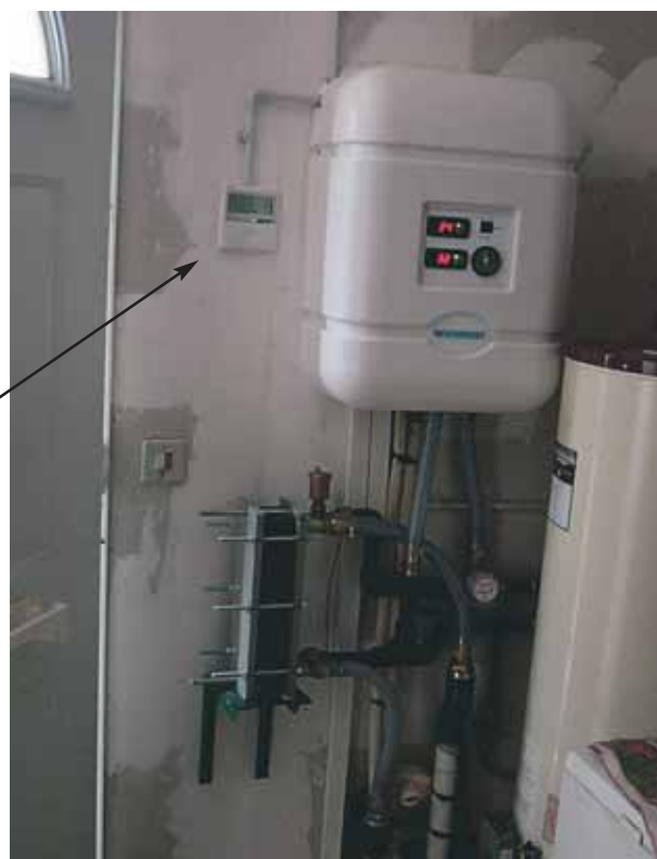
Platine de commande installée près de l'unité intérieure
